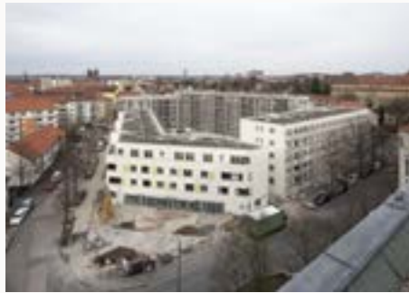
Im Jahr 2019 wurde in der Pillenreuther Straße an den 133 Mietwohnungen noch gebaut. Der Bezug findet nun im Jahr 2020 statt. Foto: Stefan Meyer
